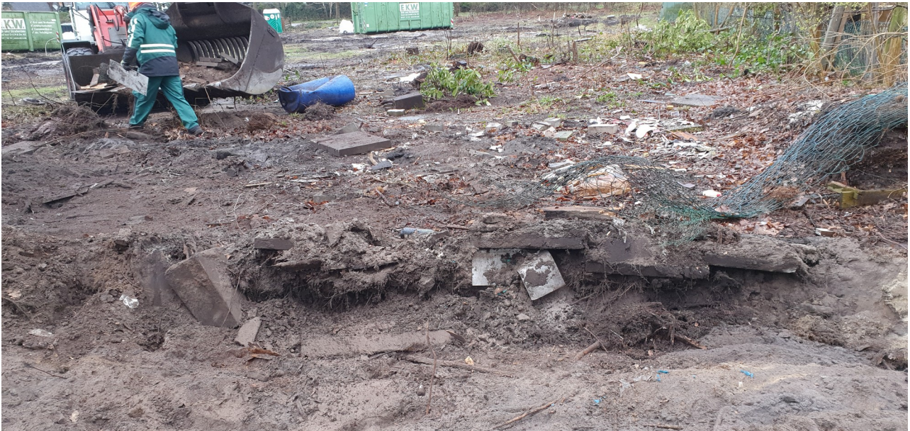
Foto 2: Abtrennung von Bauschutt und anderen Fremdbestandteilen aus dem humosen Oberboden, Foto 10.03.2020, Amt Geest und Marsch Südholstein
